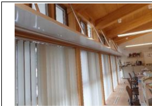
自然光を室内に導くためのライトシェルフ （福島県須賀川土木事務所事例、公共建築物（庁舎）における ZEB 事例集（国土交通省））
