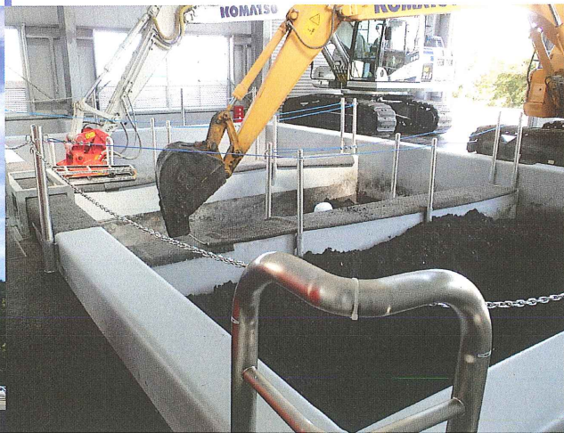
焼却灰セメント混練施設の内部
