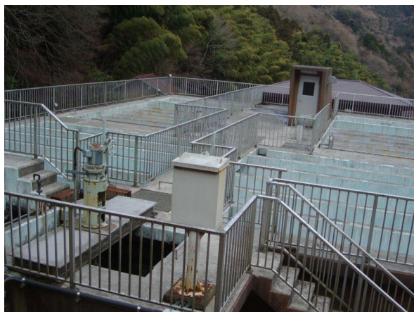
写真 2.10 広河原浄水場内②
