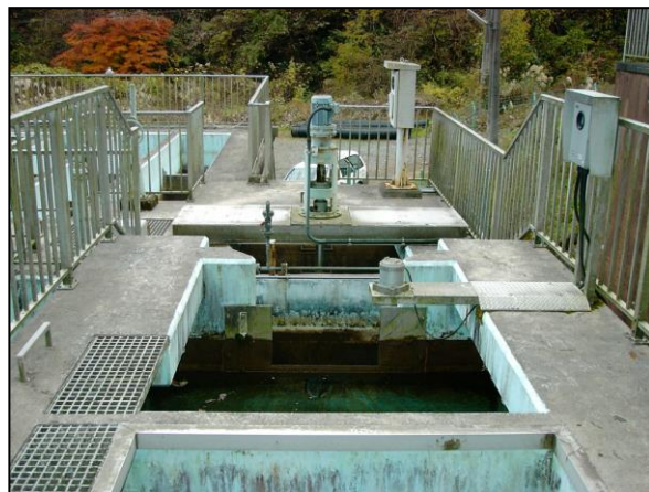
写真 2.9 広河原浄水場内①
