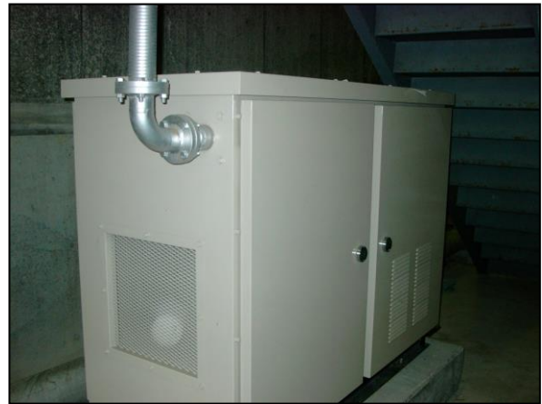
写真 2.12 広河原浄水場内自家発電機
