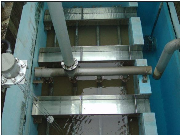
写真 2.6 尾崎浄水場ろ過池
