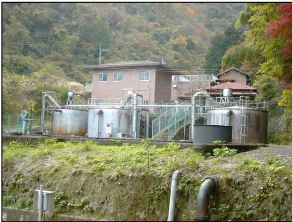
写真 2.11 広河原浄水場急速ろ過機
