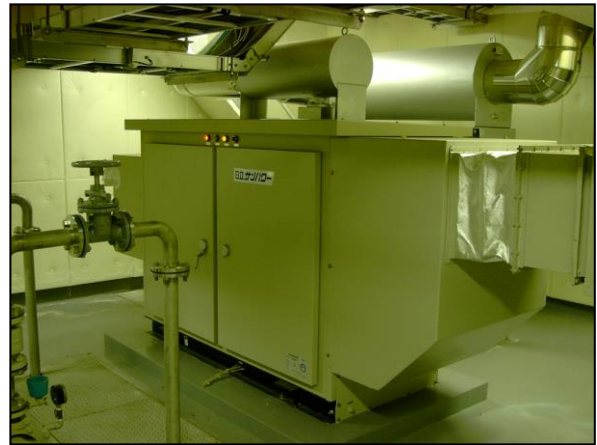
写真 2.5 南郷浄水場内自家発電機
