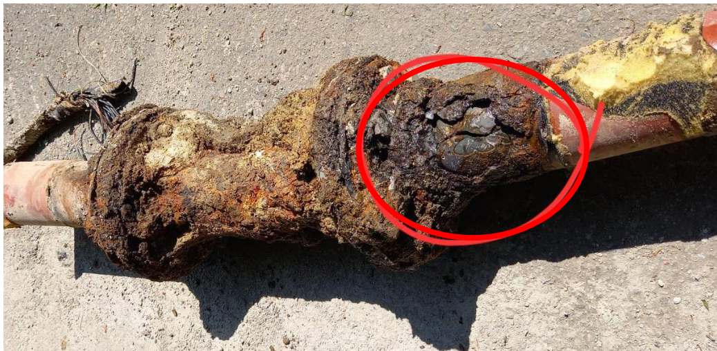
劣化(腐食)した管の継手が圧送の負荷等により破損(剥離)
