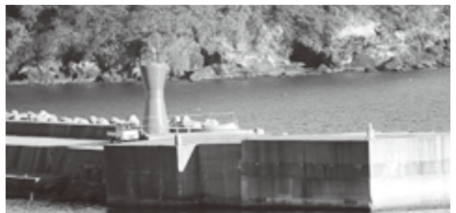
被害を受けた防波堤
