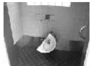
使用できなくなった公衆便所 (亀ヶ原公園)
