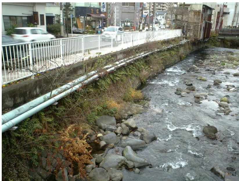
千歳川護岸に添架される送配湯管
